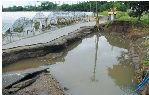
決壊した大刀洗川の堤防(高樋)
