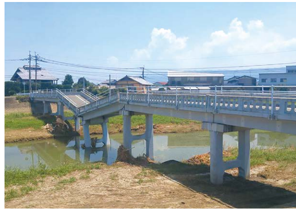
崩落した菅野橋
