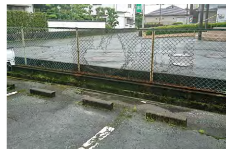
破損したフェンス(本郷)
