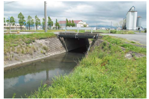
早期の改修が望まれる
