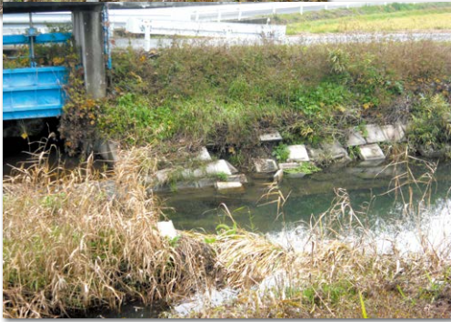
ブロックが崩れた陣屋川(南本郷)
