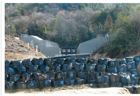
災害復旧が進められている(熊野町)
