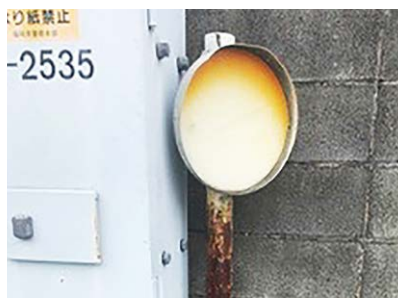
老朽化し壊れた反射板
