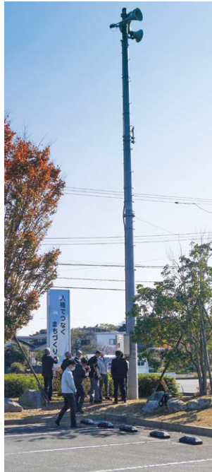
小郡市の防災無線を調査
