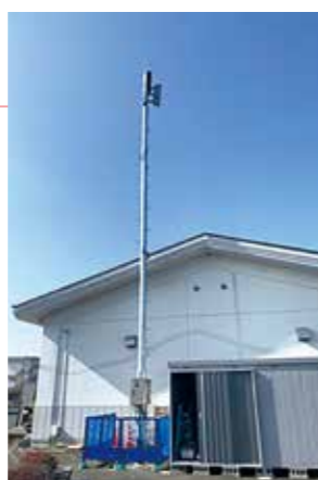
設置された防災無線
