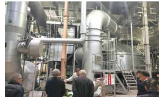
両筑苑の処理施設
