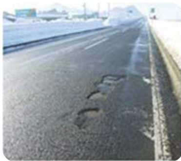
路面の穴ぼこ・ 段差
