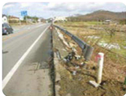
ガードレール・ 標識等の損傷
